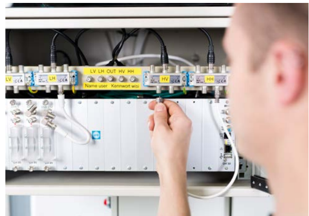
Abbildung 2: Kopfstation einer Satellitenanlage (Quelle: ZVEH)
